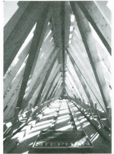
Bild 3.20 Fußgängerbrücke über den Neckar in Remsek, Spannweite 80 m, mit Glaseindeckung, Ausführung: Fa. P. Stephan, Gaidorf, 1988/89 (Bilder aus bauen mit Holz (1988) 12, S. 830) b) Blick in die Brücke
