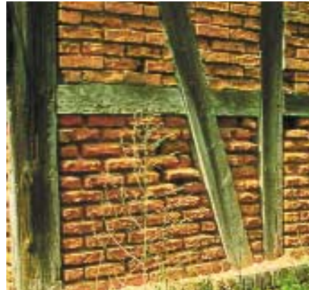
Abb. 4.8: Zerstörte Ziegel im Gefach
