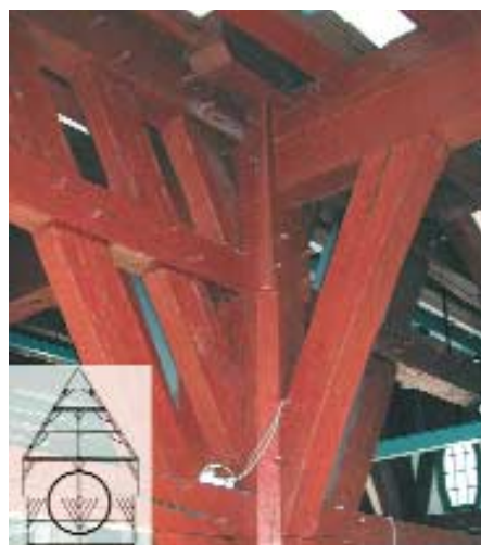
Abb. 3.10: Mittlere Stütze im Erdgeschoss des Rathauses Esslingen (Skizze [29])
